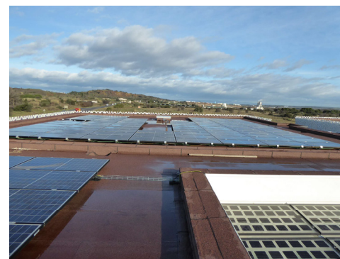
PV sur bureaux à Bessan – photo LF/PLUS DE VERT
